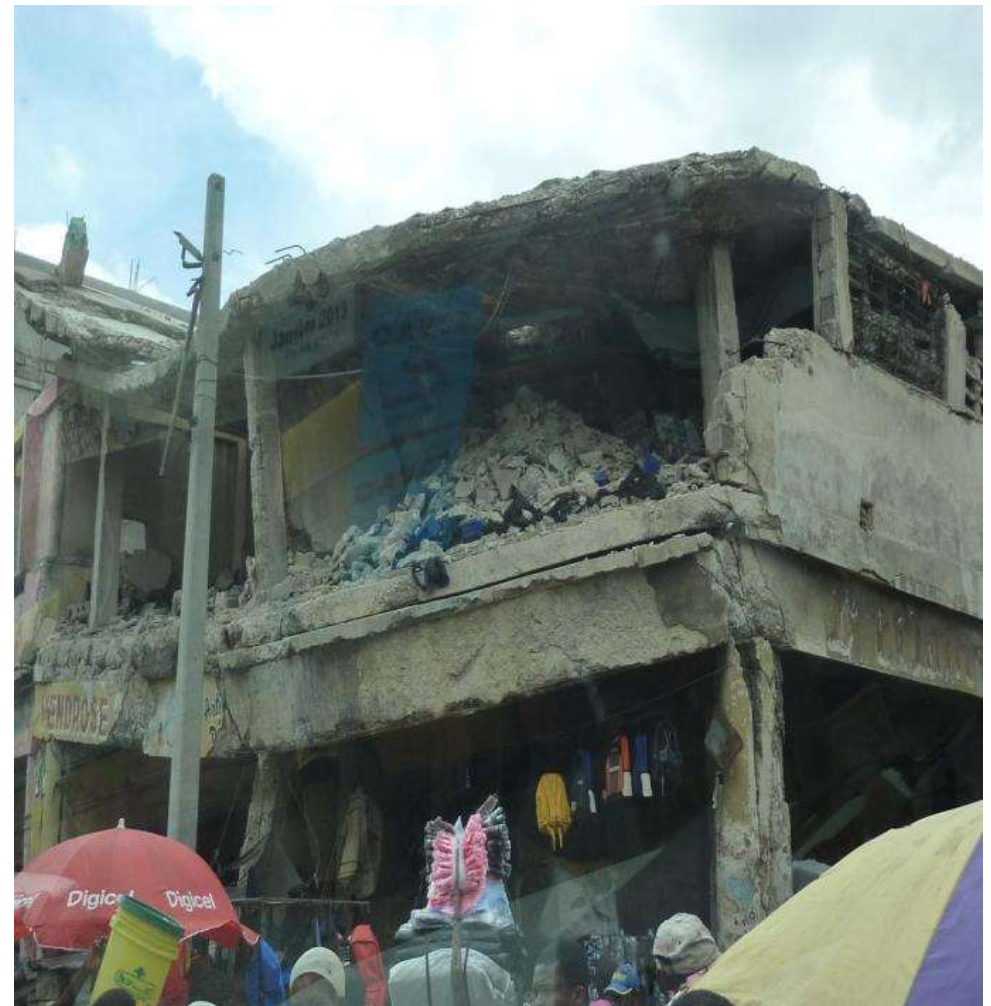
Die Menschen leben und arbeiten in den einsturzbedrohten Gebäuden
